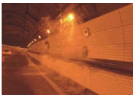
防災本管の漏水発生状況
