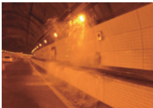
防災本管の漏水発生状況
