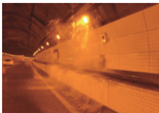
防災本管の漏水発生状況
